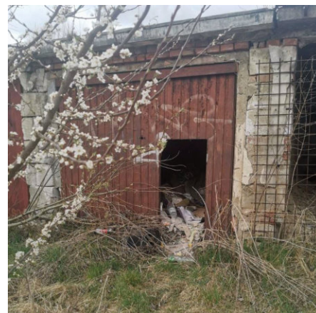
Garáže na ulici Dlouhá – nalezeny známky squattingu. Foto: Ratolest Brno
