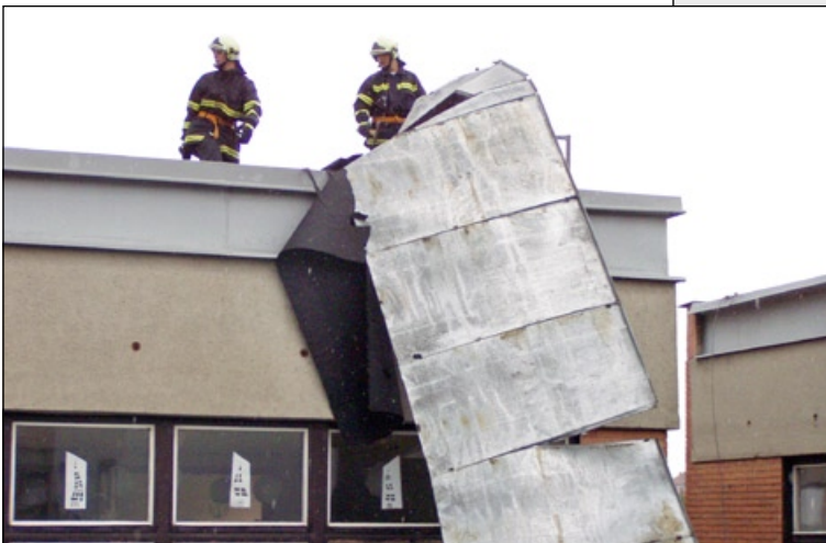
Likvidace škod na střeše ZŠ po větrné smršti 24. 6. 2008.
