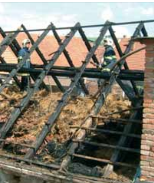
Požár hospodářského přístavku RD Bedřichovice, 27. 5. 2006
